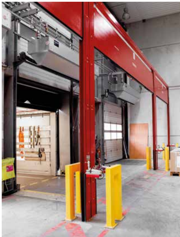
Löschwasserrückhaltebarrieren bei allen Ausgängen
